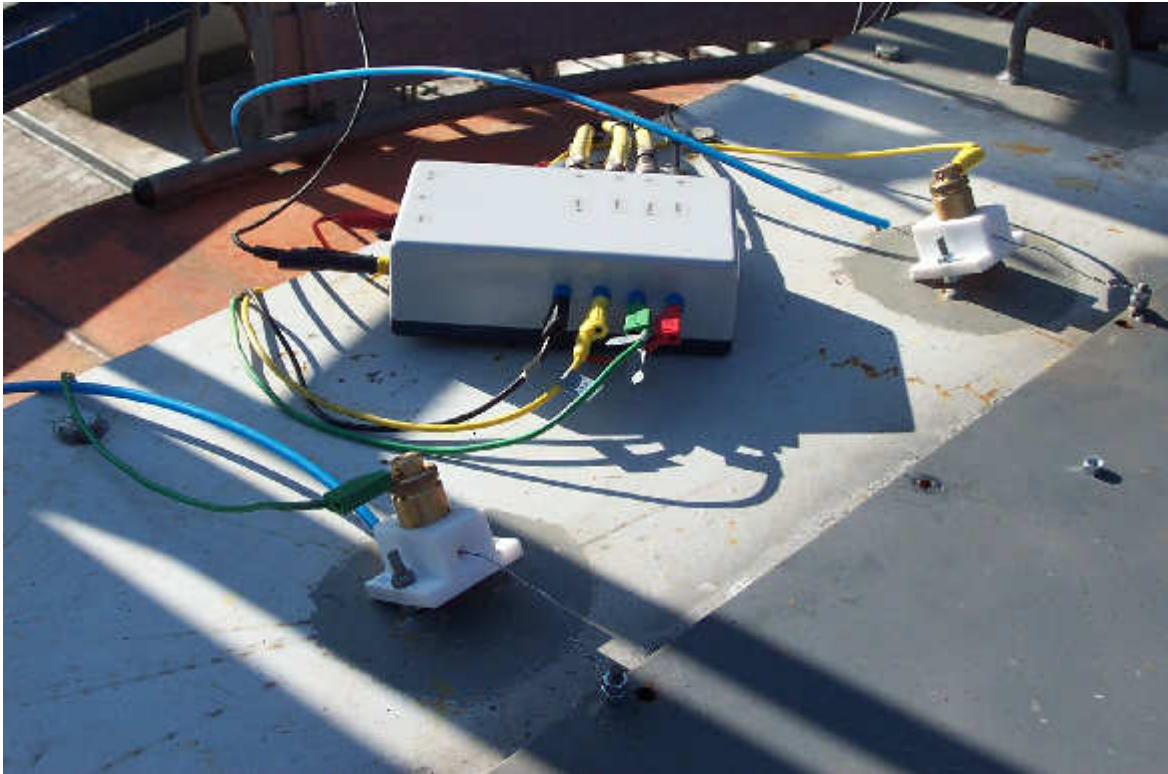
Abbildung 3.9: Zwei der insgesamt vier Schleifkontakte zusammen mit der zugehörigen Elektronik kurz vor dem Versuch.
