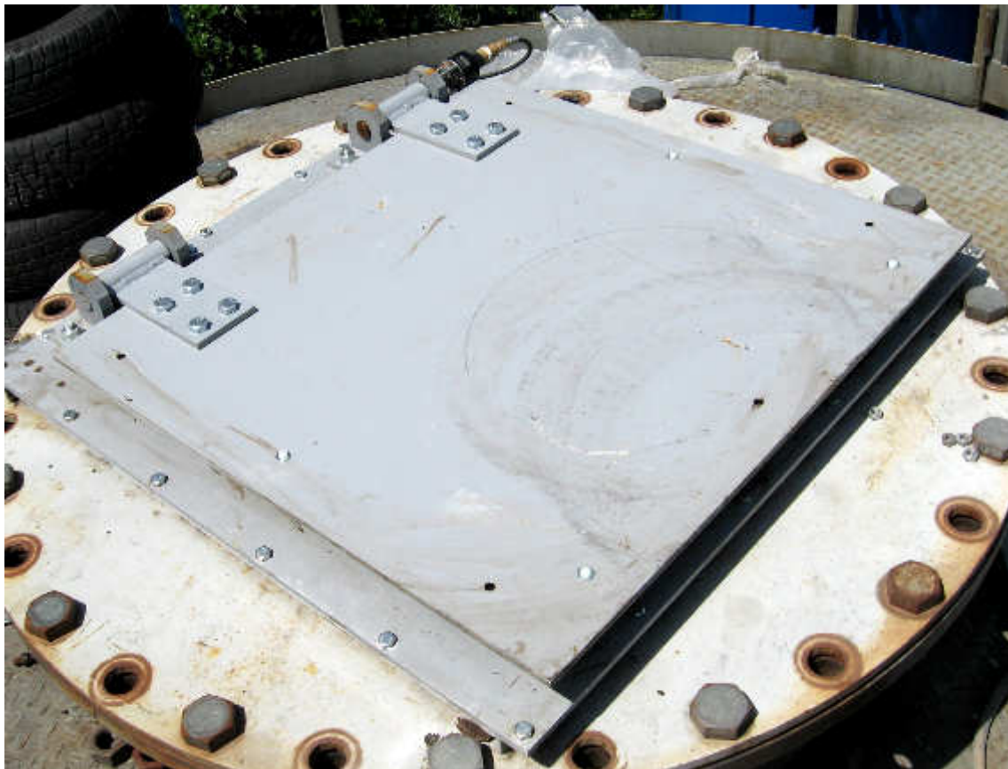
Abbildung 6.18: Massive Druckentlastungsklappe auf dem 27 m 3 -Behälter in Kappelrodeck. Die Klappe ist mit vier M6-Schrauben aus Polyamid 6.6 verschlossen.
