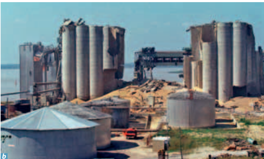
Bild 1 Explosionsauswirkungen: a) Auswirkungen nach einer Gasexplosion in einem Kraftwerk. b) Nach einer Staubexplosion standen von 44 Silozellen einer Kornsilanlage nur noch wenige, jedoch schwer beschädigte Zellen
