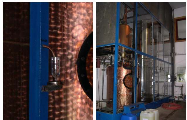
Abb. 9: Offenes Probenahmegefäß (Füllmenge 2 cl), Verdunstungsrate sowie Position lassen zusammenhängende explosionsfähige Atmosphäre in gefahrdrohender Menge (mehr als 10 l) um Probenahmestelle nicht entstehen -> Keine Zone
