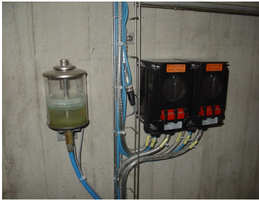
Abb. 16: Sperrwasserkontrolle für Alkoholpumpen
