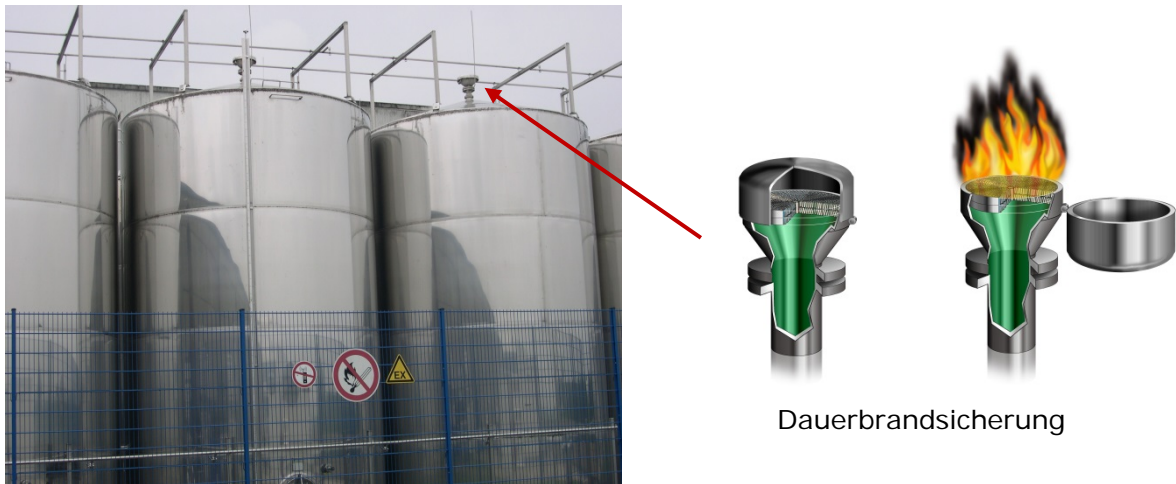
Abb. 20: Explosionsschutz an Außentanklager
